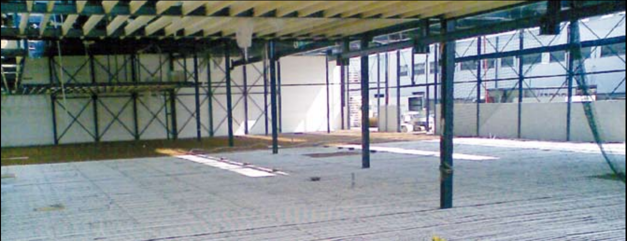
Betonkernactivering (BKA) bedrijfspshal te Lopik
